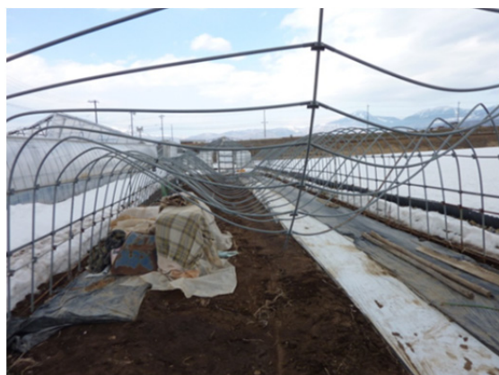
単棟パイプハウスのM字型陥没
